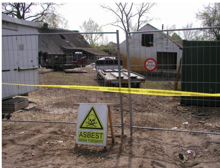
Figuur 17: Afscherming van een asbestverdachte locatie
